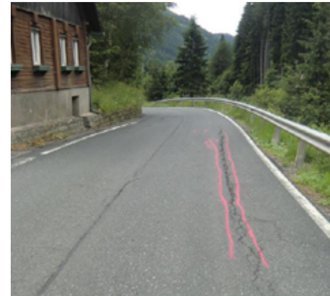
Darum geht es: An dieser Stelle ist der Teilnehmer 2016 schwer gestürzt. Der Riss, der den Sturz ausgelöst haben soll ist auf diesem Foto noch zu sehen und rot markiert, mittlerweile aber ausgebessert.
